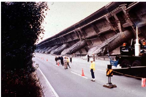
Photo A : la ruine d'un pont lors du séisme de Kobé par effet de pendule inversé
